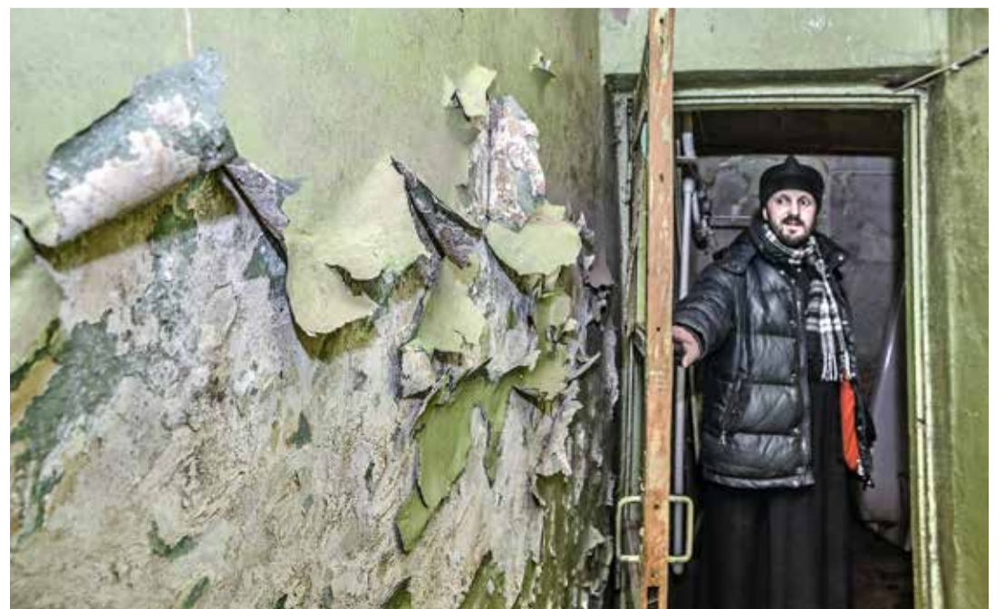
Das Gebäude der Arche ist in schlechtem Zustand, es besteht auch ein Sicherheitsrisiko.
